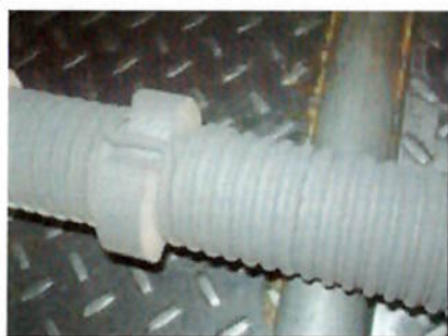
Figura 40 - Exemplo de curto de fuga entre resistência e carcaça e tubo radiante.
