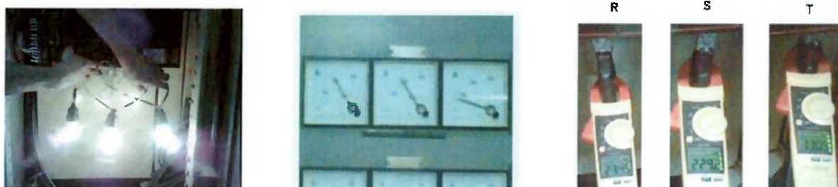
Figura 36 - Procedimento do teste de lâmpadas, verificação pelos amperímetros e constatação de problema com instrumento adequado.
