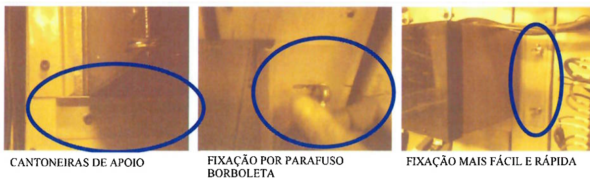
Figura 49 - Melhoria na forma de fixação dos módulos de potência CPC.
